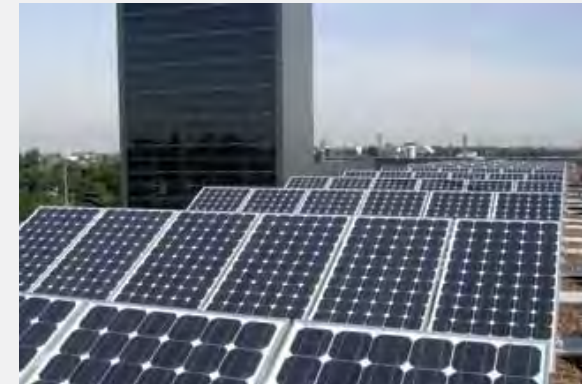
Bild: PV Anlage Feuerwache in Heidelberg
