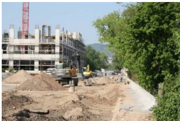
Blick vom „Langen Anger“ auf die Erschließungsmaßnahme „Max-Jarecki-Straße“ und Hochbaumaßnahme „Sky Labs“ auf dem Baufeld Z 3
