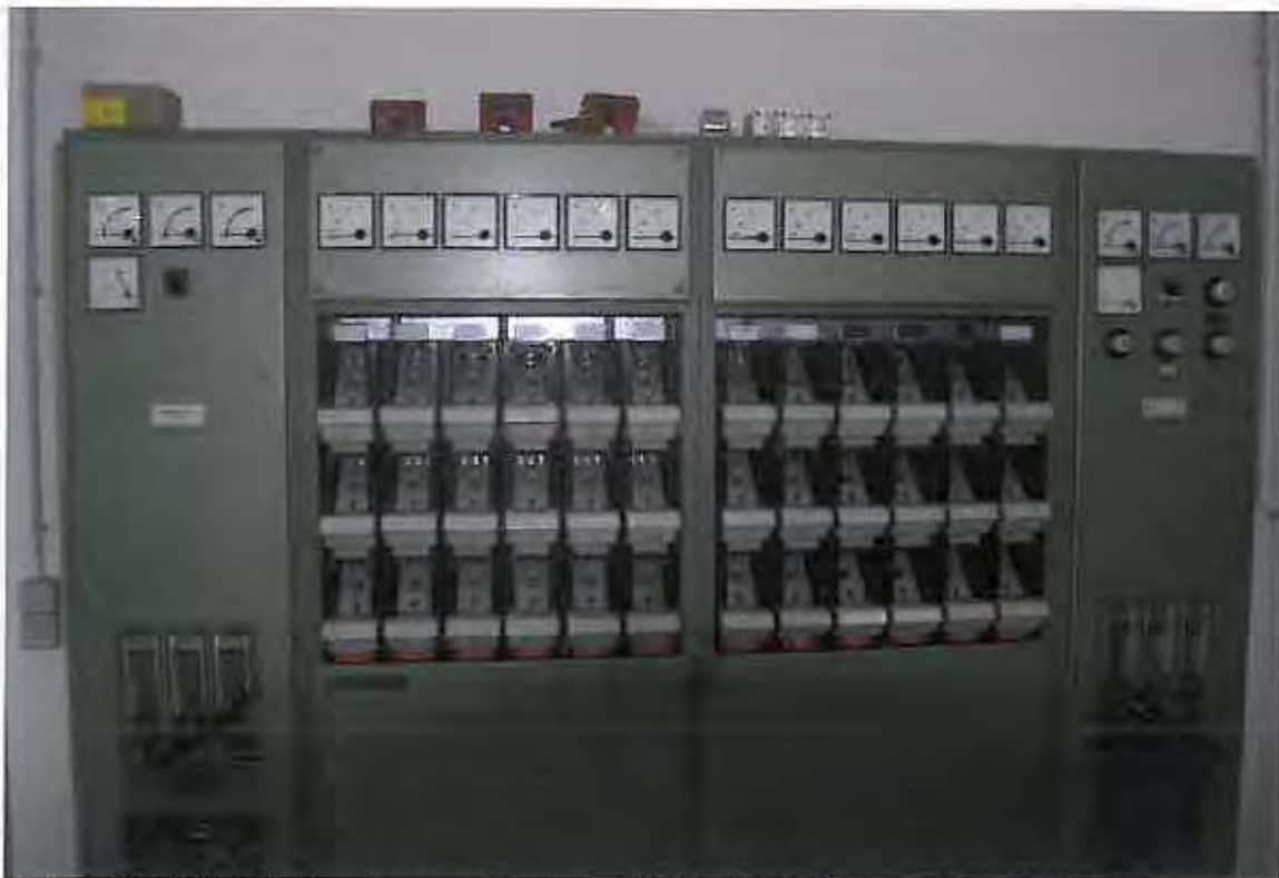
Abb. 8: 0,4 kV – Niederspannungsanlage mit Schaltfeld für zwei Transformatoren
