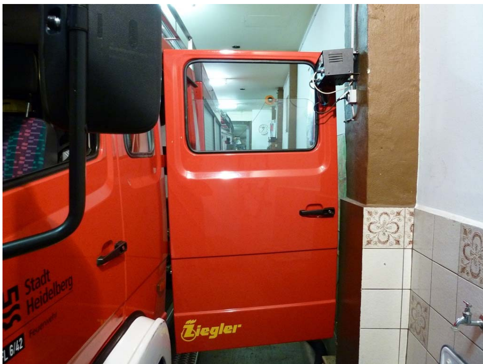
Bild 4: nicht eingehaltener Sicherheitsabstand von 0,5 Metern bei geöffneter Tür zur Wand (Vorgabe Unfallverhütungsvorschrift Feuerwehr)
