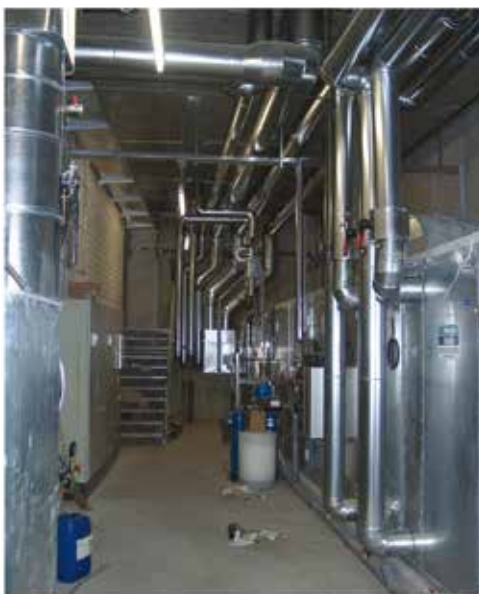
Abb. 3 Lüftungszentrale ENERGON (Quelle: ebök)
