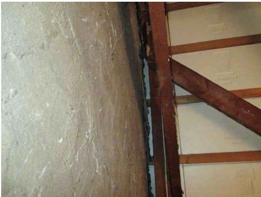
Foto 5: Spalte am Giebelrand
