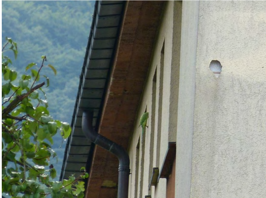
Abbildung 20 Wärmedämmfassaden am Sickingenplatz mit insgesamt mind. 114 Spechtlöchern. Brut- platz u.a. von Halsband- sittich.
