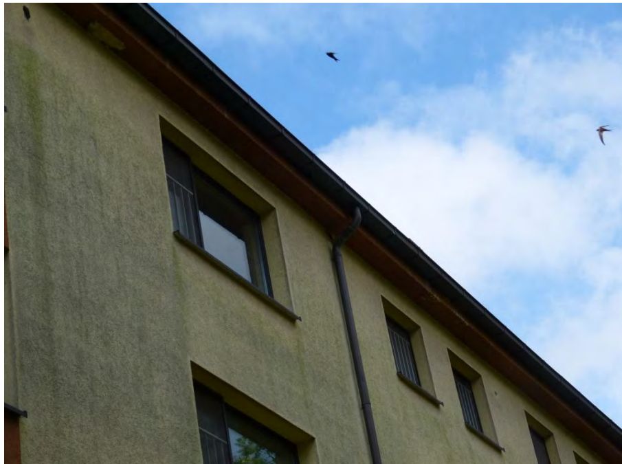
Abbildung 21 Brutplätze von Mauer- seglern am Sickingenplatz lagen unter der Dachrinne.
