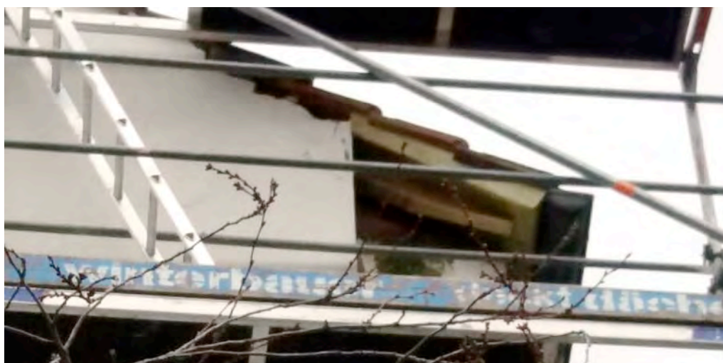
Bereits reparierter Schaden der Dacheindeckung (Foto: Mezger)
