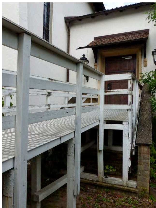
Rampe zur barrierefreien Erschließung eines nur kleinen Teils der Chapel. Die aus Holzständerwerk errichtete Rampe befindet sich nicht nur in einem bedenklichen Zustand, sondern verschattet in dieser Bauform auch die gesamten südlichen Räume des Souterrains. (Foto: Keller)
