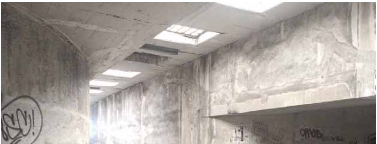
Schadhafte Dachoberlichter Posttunnel Teilbereich 2
