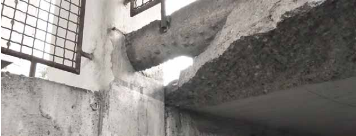
Beispiel Schadstelle - Posttunnel Teilbereich 2
