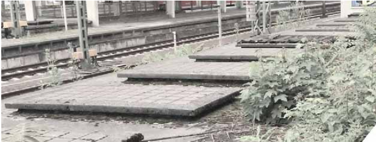
Schadhafte Dachoberlichter Posttunnel Teilbereich 2 - Außenansicht
