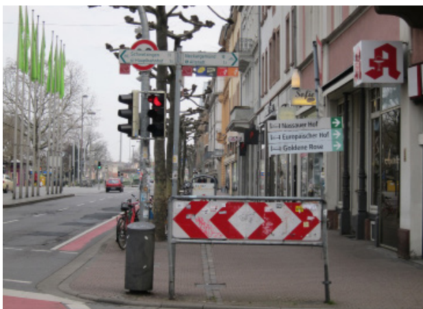
Altstadt, Sofienstraße 2016 Schäden im Oberflächenbelag nach Abbau des Ge- länders mit Fahrradbügeln, veraltete Stadtmöbli- erung, Behinderung der Passanten durch Geländer
