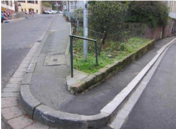
Altstadt, Bremeneck gegenüber Haltestelle 2017 Der Bereich vermittelt einen ungepflegten Eindruck, durch schadhafte Sandsteinmauer und verschiedene Geländer.
